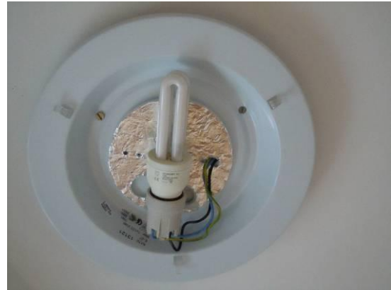
Újonnan beszerelt energiatakarékos izzó
